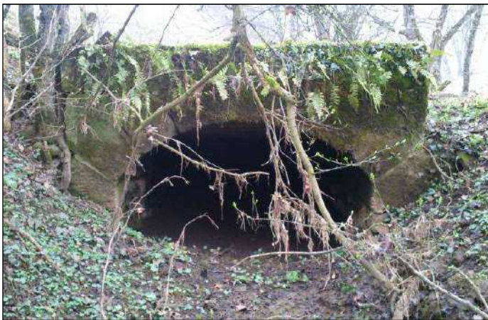
Sortie de l'aqueduc constituant la prise d'eau (dépôt de vase en fond)
