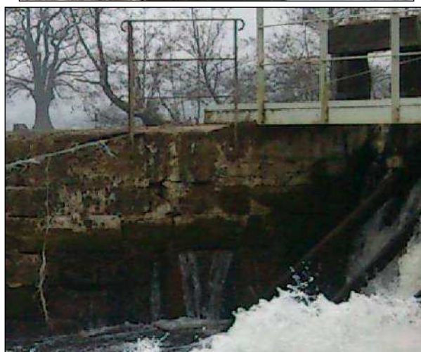
Dégradation du seuil en aval
