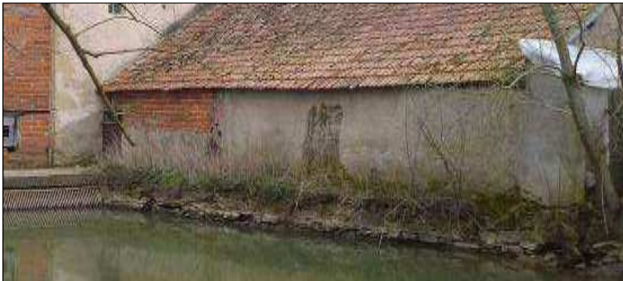
Dégradation du mur de fondation du bief – Rive droite
