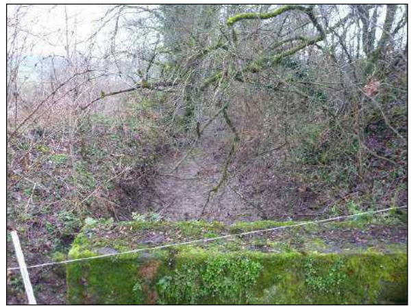
Fossé d'irrigation en aval de la prise d'eau à reprofiler
