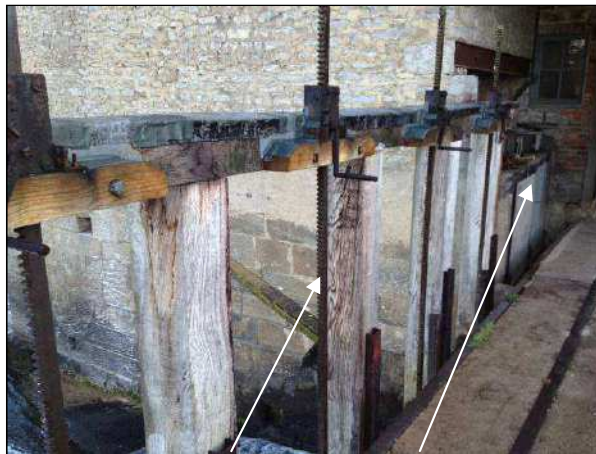
Vannes de décharge et vannes motrices
