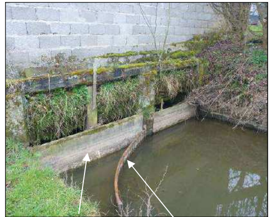
Vannes motrices et grille de protection
