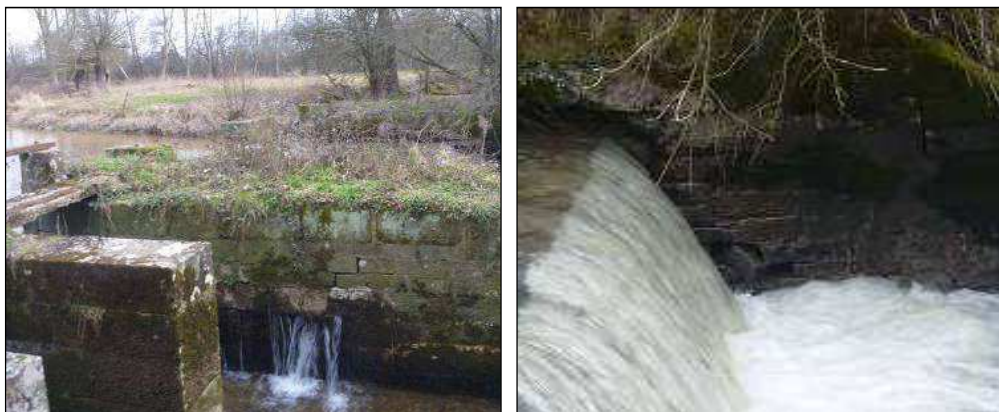
Désordres observés – déversoir amont
