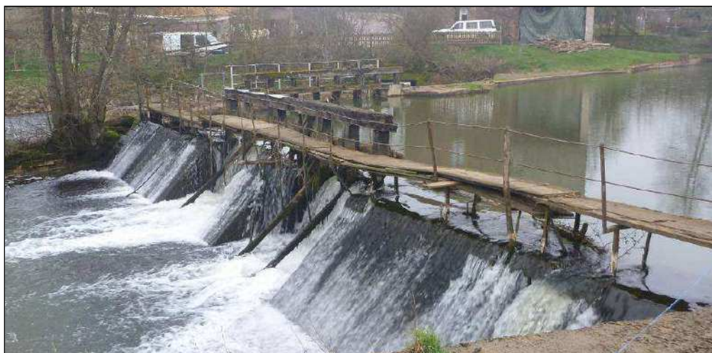
Très mauvais état de la passerelle « rive gauche »
