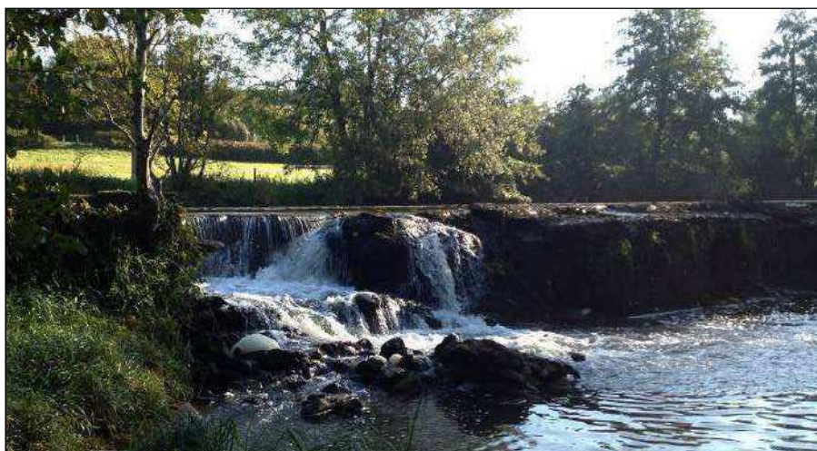
Dégradation au Nord du seuil
