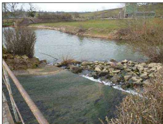
Seuil de décharge secondaire
