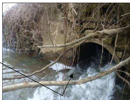
Canalisation de vidange
