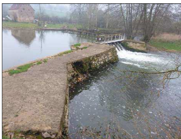
Vannage sur seuil – Rive Droite
